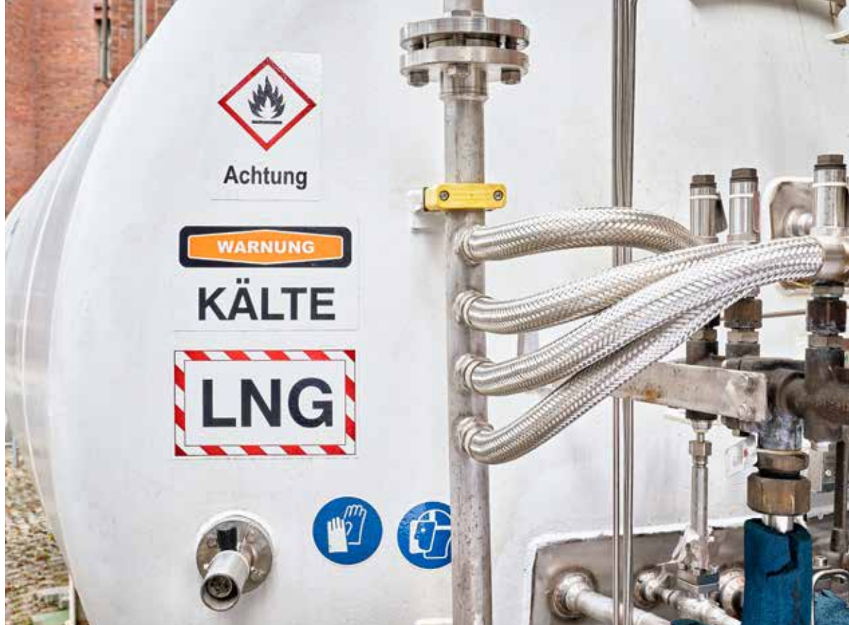
Der Flüssiggastank auf dem TU-Gelände fasst drei Tonnen
