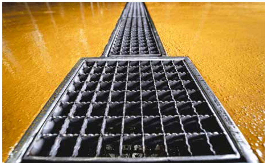
Bodenablauf aus Stahl in einer Brauerei
